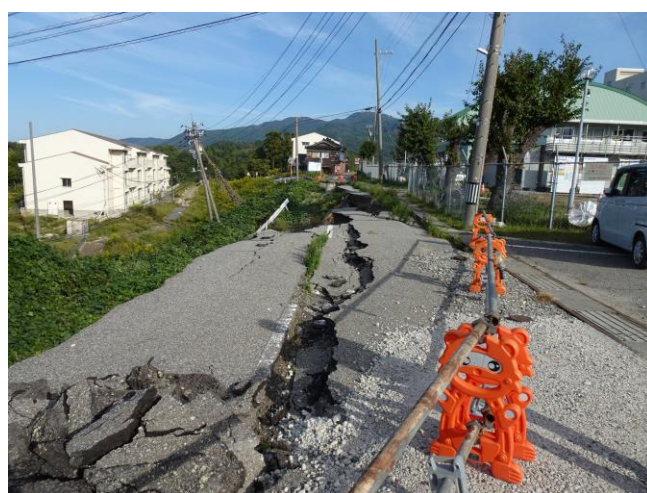
高台にある輪島中学校への通学路は、車道部分が崩落し、子どもたちは残った右端の歩道を通って通学しています。
